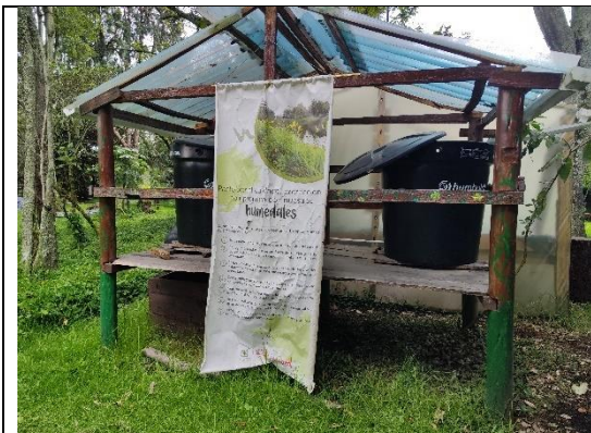
Fotografía 21. tanques de almacenamiento de agua lluvia
