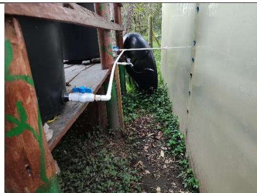
Fotografía 22. Sistema de circulación de agua de taques
