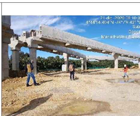
Fotografía 74 Recorrido obras con SCAPS verificación POC y avance de las obras de corredores.
