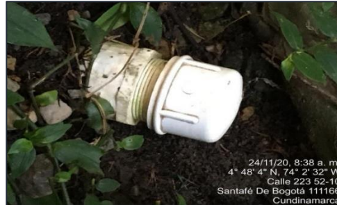
Fotografía 13 Conexión errada no identificada que vierte al Canal Guaymaral.
