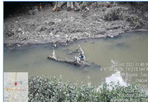
Fotografía 15 Presencia de residuos sólidos Canal Guaymaral, PEDH Torca y Guaymaral.
