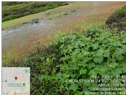
Fotografía 28 Presencia de material vegetal flotante espejos de agua Sector Guaymaral sector 6 de mantenimiento.
