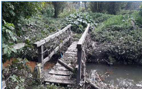
Fotografía 8 Presencia de residuos sólidos vallado innominado sector Torca PEDH Torca y Guaymaral.
