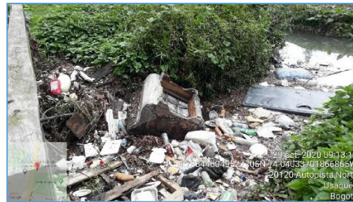
Fotografía 9 Presencia de residuos sólidos vallado innominado sector Torca PEDH Torca y Guaymaral.
